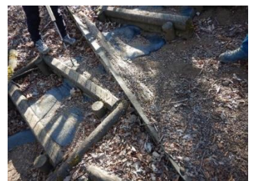
点検対象物の階段(水切りが倒れている)
